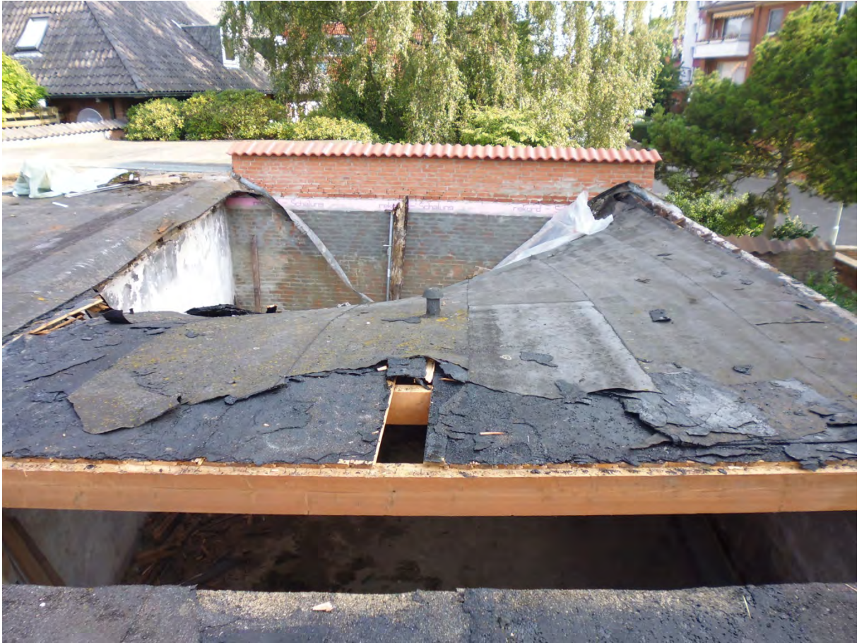
Abbruch der durch Feuchtigkeit beschädigten Dachkonstruktion
