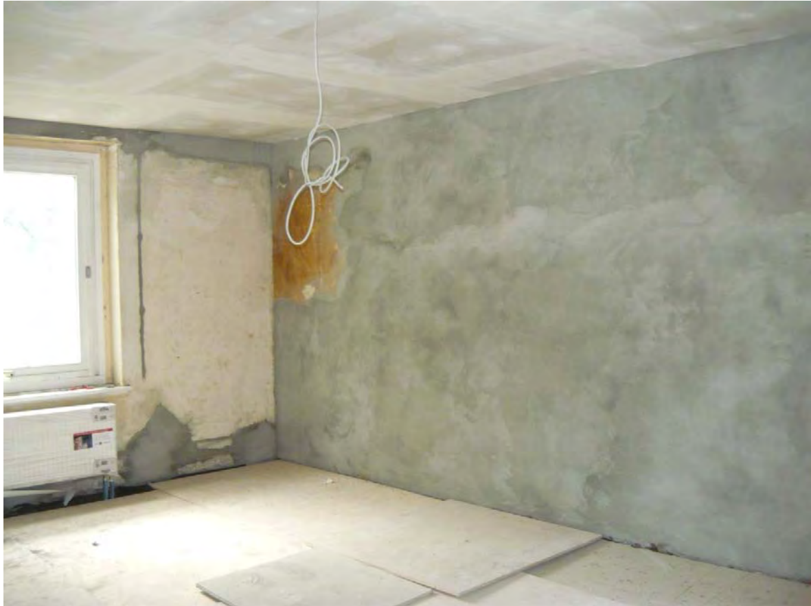
Großflächige Putzerneuerungen im Innenbereich
